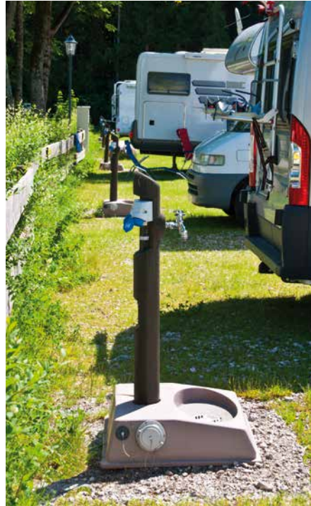
Versorgungssäule mit Strom-, Wasser- und Abwasseranschluss.
